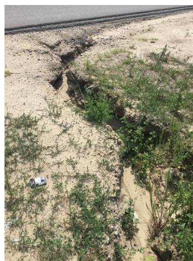
Fig. 26: Șiroire pe marginea drumului Craiova-Bechet
